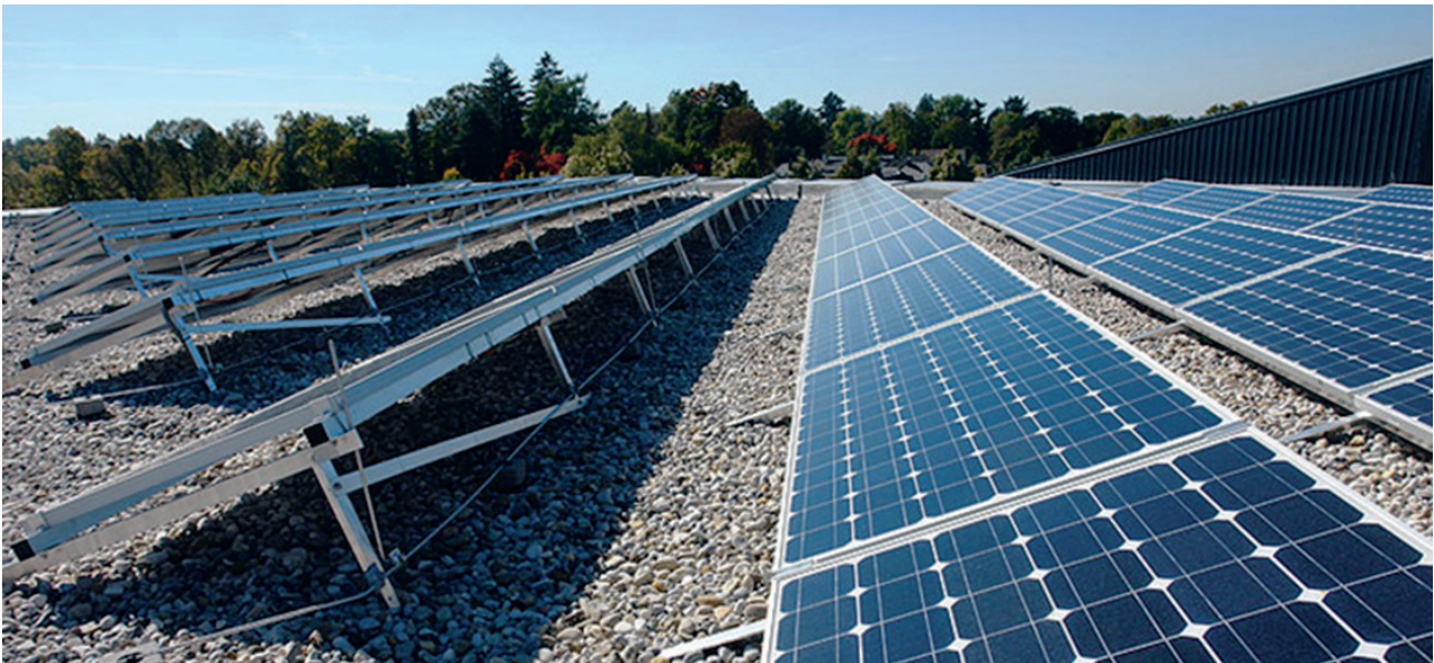
Bis zu 86.000 Kilowattstunden Solarstrom jährlich produziert Bavaria Film mit den Photovoltaikanlagen auf den Dächern seiner Neubauten.
